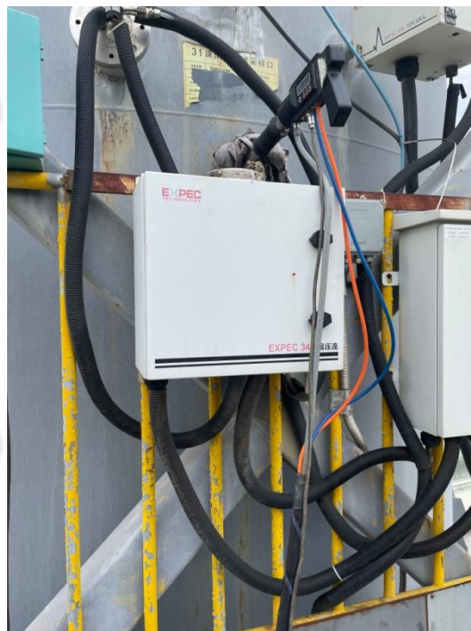
101 车间总排口 (DA001)
