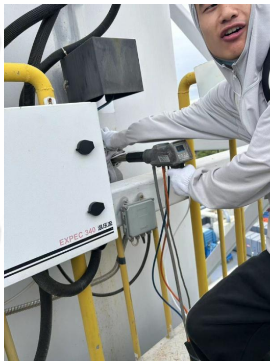
501 车间总排口 (DA003)
