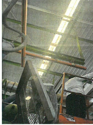
106 配料室排气筒 3#出口 (FO-440217)
