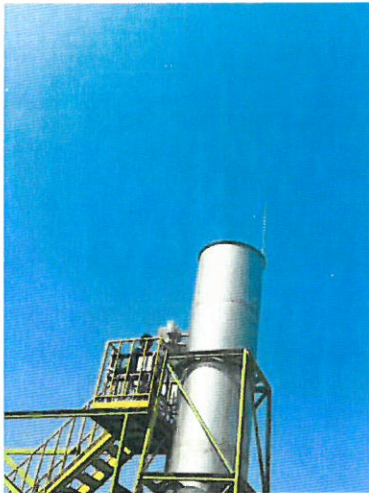
302 硫化废气处理设施出口 (FQ-440205)
