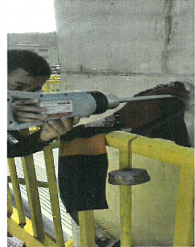
103B 硫化 71 课车间废气处 理设施出口 (FQ-440204)
