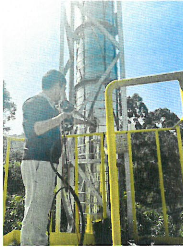
302 检修排气筒出口 (FO-440213)
