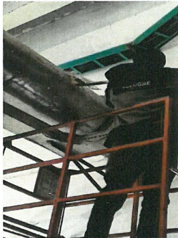
106 配料室排气筒 2#出口 (FO-440216)
