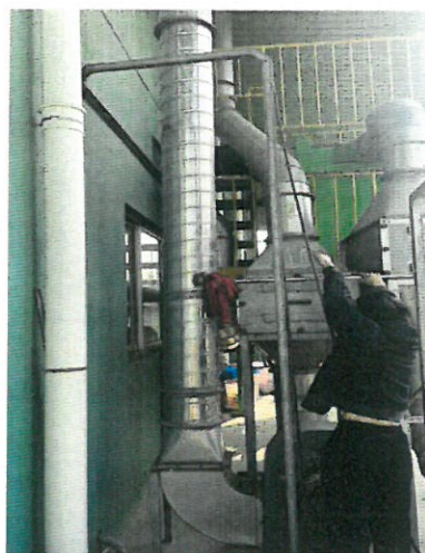
101B 配药车间废气排气筒出口 3# (DA002)
