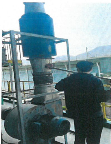
101B 配药车间废气排气筒出口 1# (DA001)
