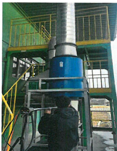
101B 配药车间废气排气筒出口 2# (DA004)
