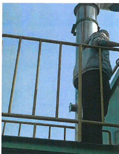
105D 磨白字车间排气筒 (DA014)
