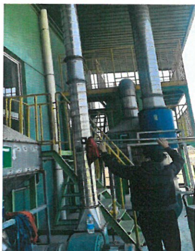
101B 配药车间废气排气筒出口 4# (DA003)
