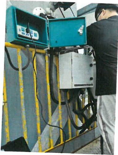
101 密炼车间排气筒出口
