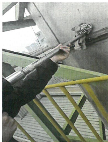
503 车间硫化车间排气筒出口 (DA023/23 号排气筒)
