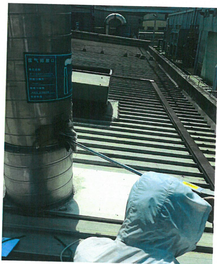
303 硫化车间排气筒出口 (DA016/16 号排气筒)
