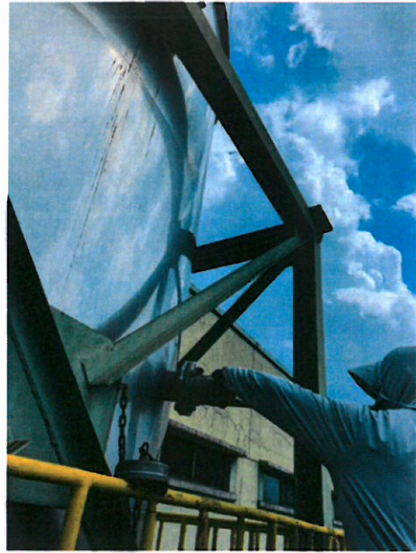
炼胶 301/501 车间排气筒出口 (DA002/2 号排气筒)
