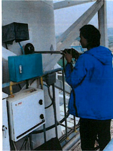
301 混炼车间排气筒出口 (DA002)
