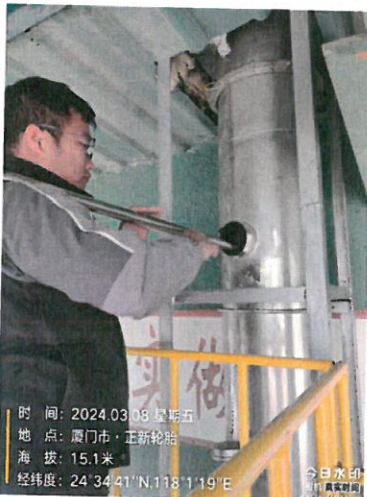
木工房洗模车间排气筒出口 DA060 (厂内编号 DA060)
