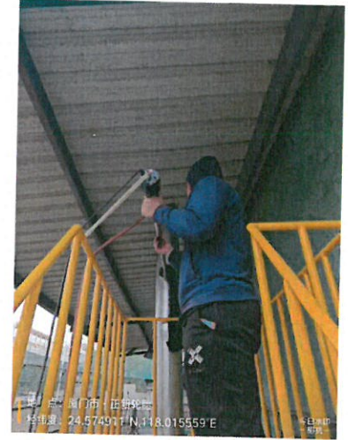
203 洗模车间排气筒出口 DA067 (厂内编号 DA067)
