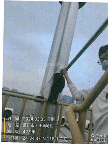
503 洗模车间排气筒出口 DA066 (厂内编号 DA066)
