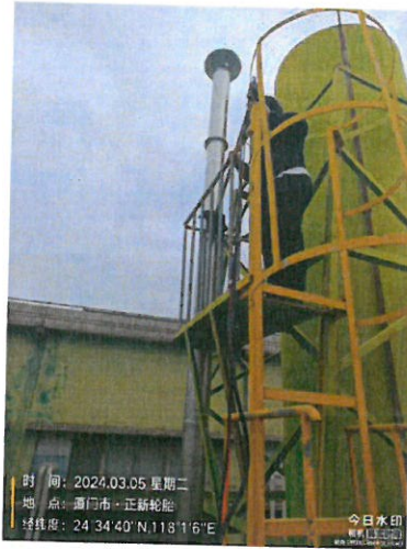
05 洗模车间排气筒出口 DA062 (厂内编号 DA062)
