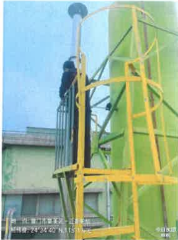
05 车间硫化车间排气筒出口 DA031 (厂内编号 DA004)
