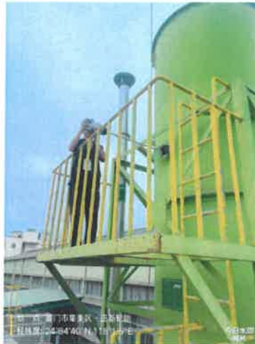
05 车间硫化车间 排气筒出口 DA030 (厂内编号 DA005)
