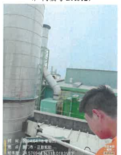
303 车间硫化车间排气筒出口 DA047 (厂内编号 DA019)
