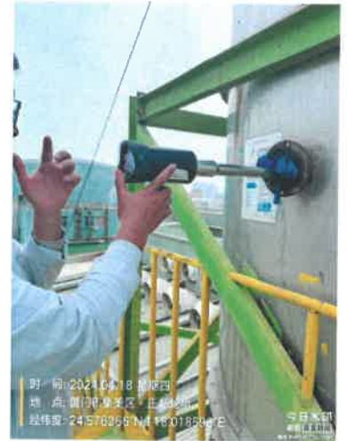
306 车间硫化车间排气筒出口 DA044 (厂内编号 DA030)
