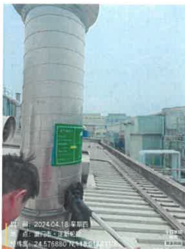
303 车间硫化车间排气筒出口 DA046 (厂内编号 DA016)
