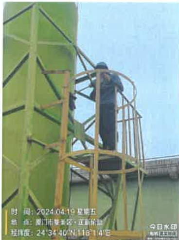
05 车间硫化车间 排气筒出口 DA032 (厂内编号 DA007)
