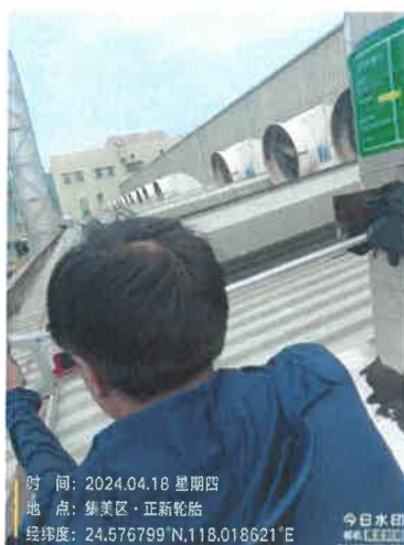
303 车间硫化车间排气筒出口 DA045 (厂内编号 DA018)
