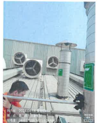
303 车间硫化车间排气筒出口 DA042 (厂内编号 DA012)
