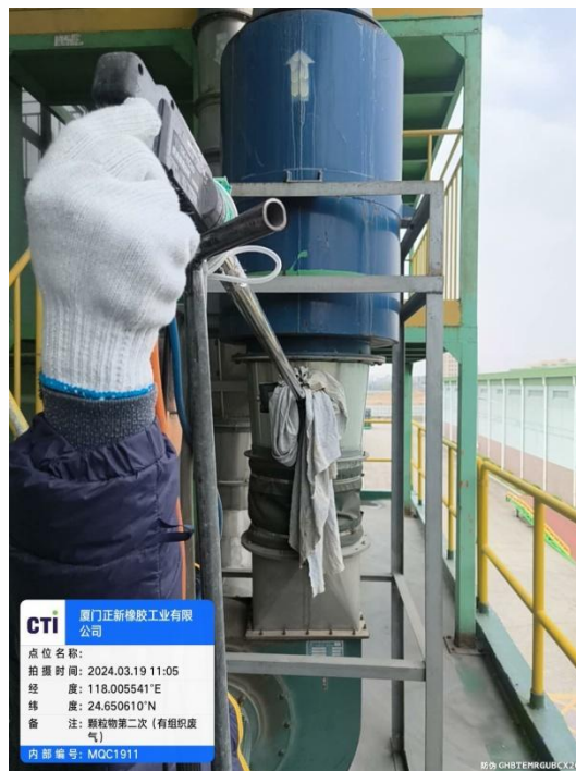
101B 配药 2#排气筒
