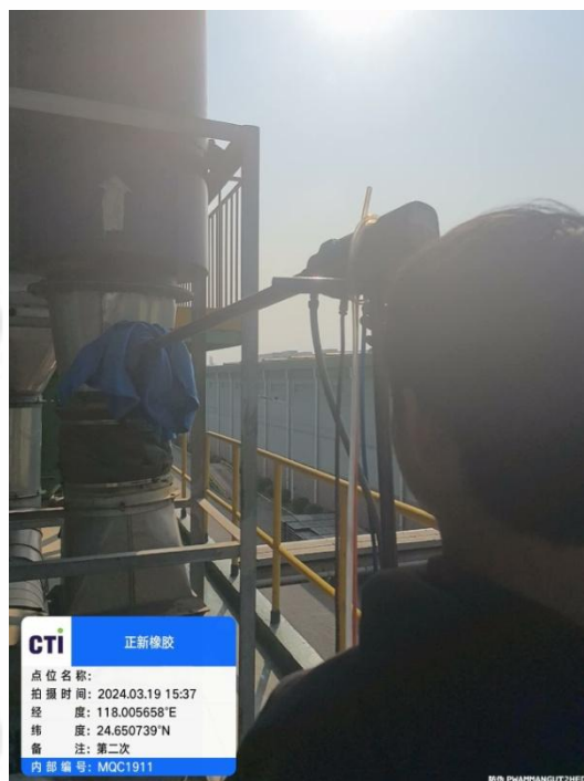
101B 配药 1#排气筒
