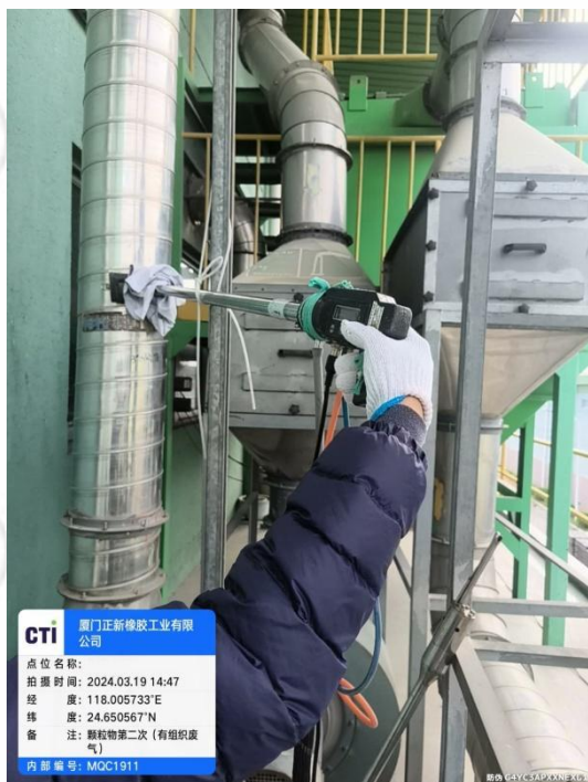
101B 配药 3#排气筒
