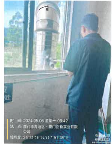
106 配料室排气筒 3# 出口 (FQ-440217)
