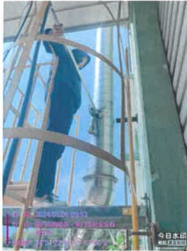
104 检修排气筒出口 (FQ-440212)
