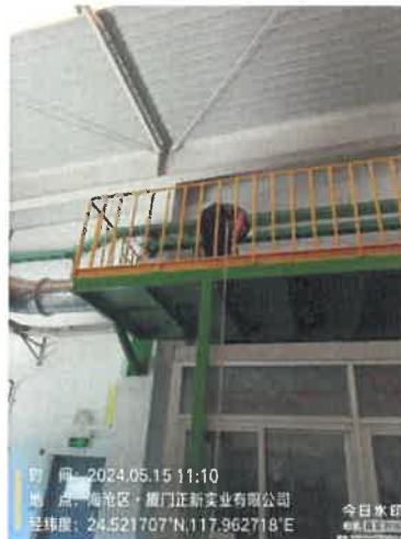
106 配料室排气筒 1# 出口
