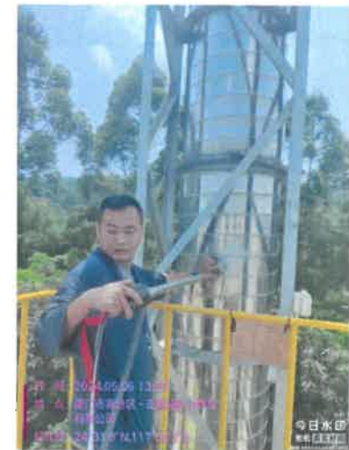
302 检修排气筒出口 (FQ-440213)
