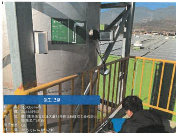
102 压延车间排气筒出口 (点位:◎5)
