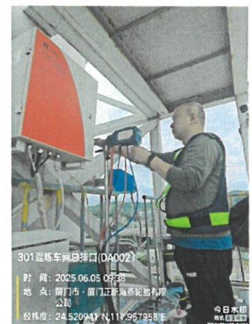
301 混炼车间总排口 (DA002)
